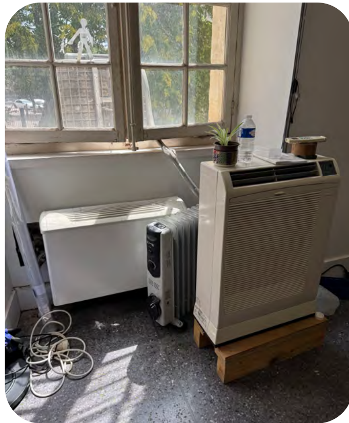
Accumulation d'appareils (chauffage, climatisation mobile) dans une pièce à fenêtre ouverte traduisant un manque de stratégie thermique cohérente.
